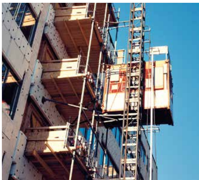
▲ Ascensori di facciata
